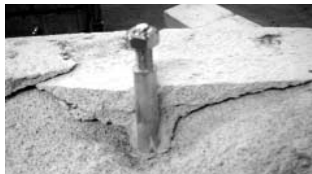
Рис.5. Вид разрушения при использовании анкера PBD 10
